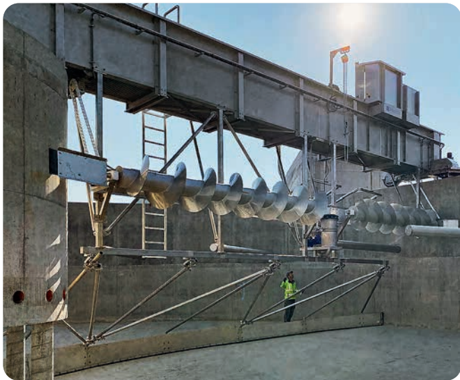
Rundräumer mit Schwimmschlamm Abzugssystem
