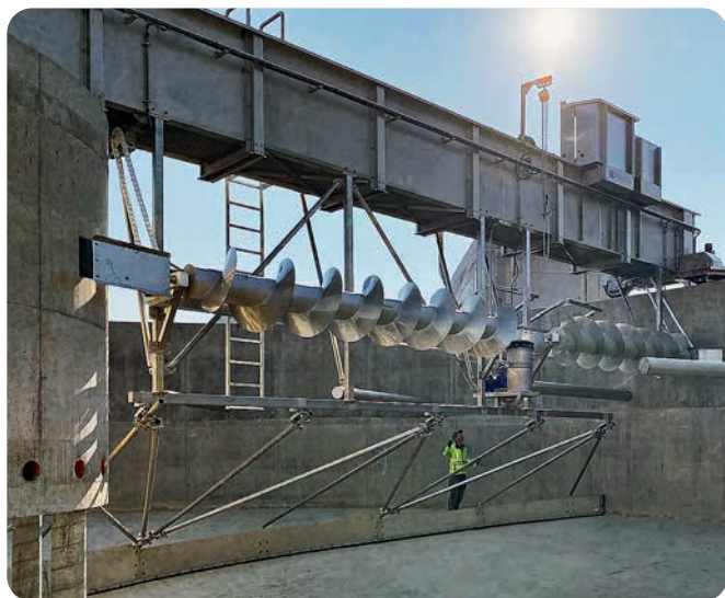
Zgarniacz radialny z systemem odciągania kożucha ściekowego
