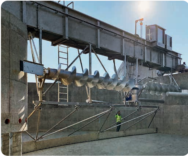
Радиальный скребок с системой удаления плавающего шлама
