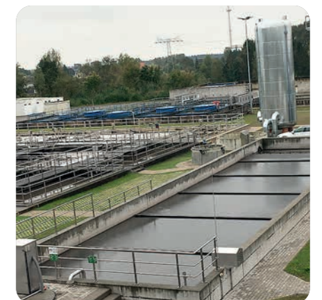
Kommunale Kläranlage mit Kettenräumer, Deutschland
