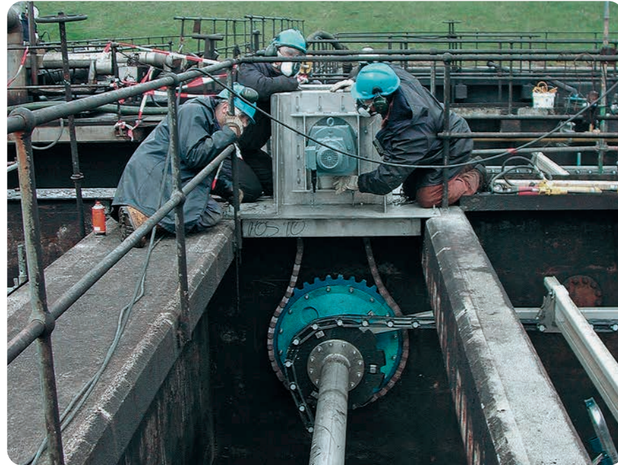
API-Absetzbecken in der Raffinerie
