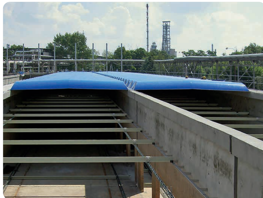
GFK-Abdeckung für API-Becken
