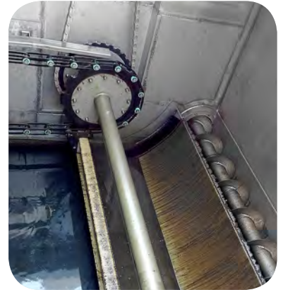
DAF-Räumer mit Schlammaustrag über Rampe mittels Schnecke
